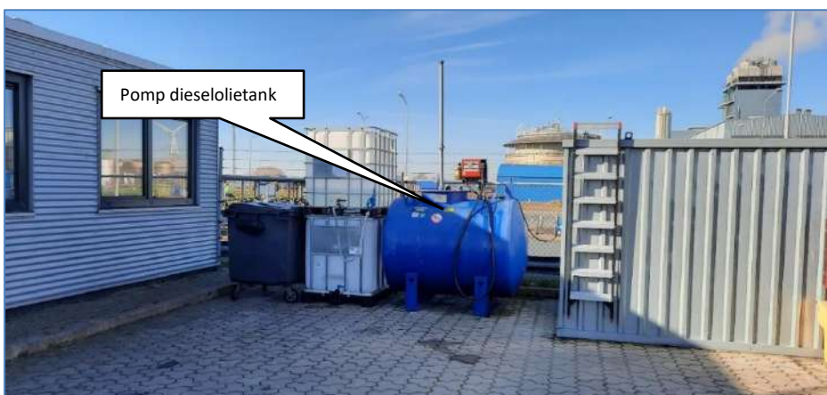
Afbeelding 5: Locatie dieseltank met pomp (nieuwe geluidbron)
