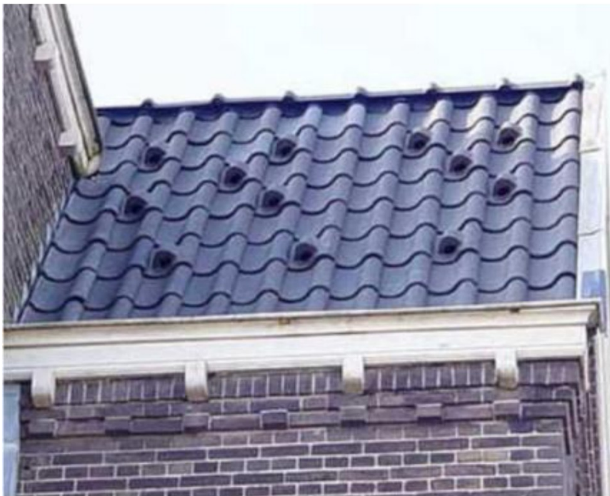
Afbeelding 2.1 Gierzwaluwpannen (bron: Arcadis)
