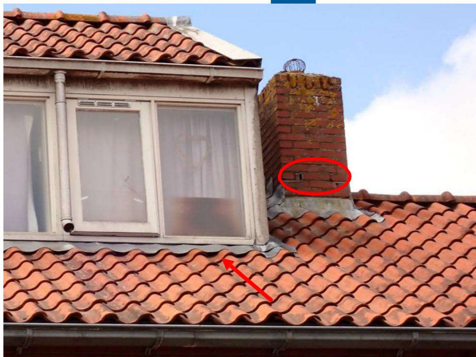
Afbeelding 2.6 Open stootvoegen in schoorsteen, opstaand lood onder dakkapel.
