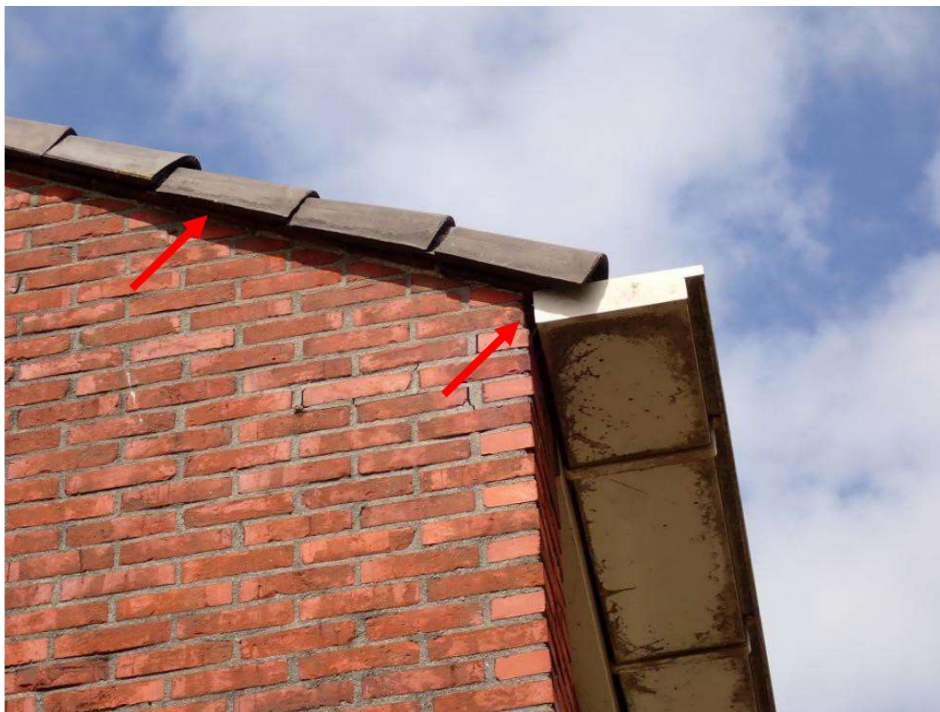
Afbeelding 2.8 Ruimte onder kantpannen en opening bij uiteinde dakgoot.
