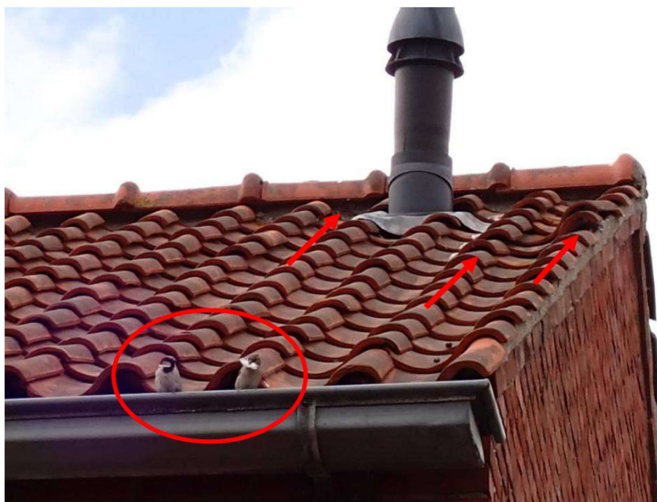
Afbeelding 2.5 Mus met nestmateriaal in dakgoot, ruimte onder nokvorst, opstaande dakpannen.
