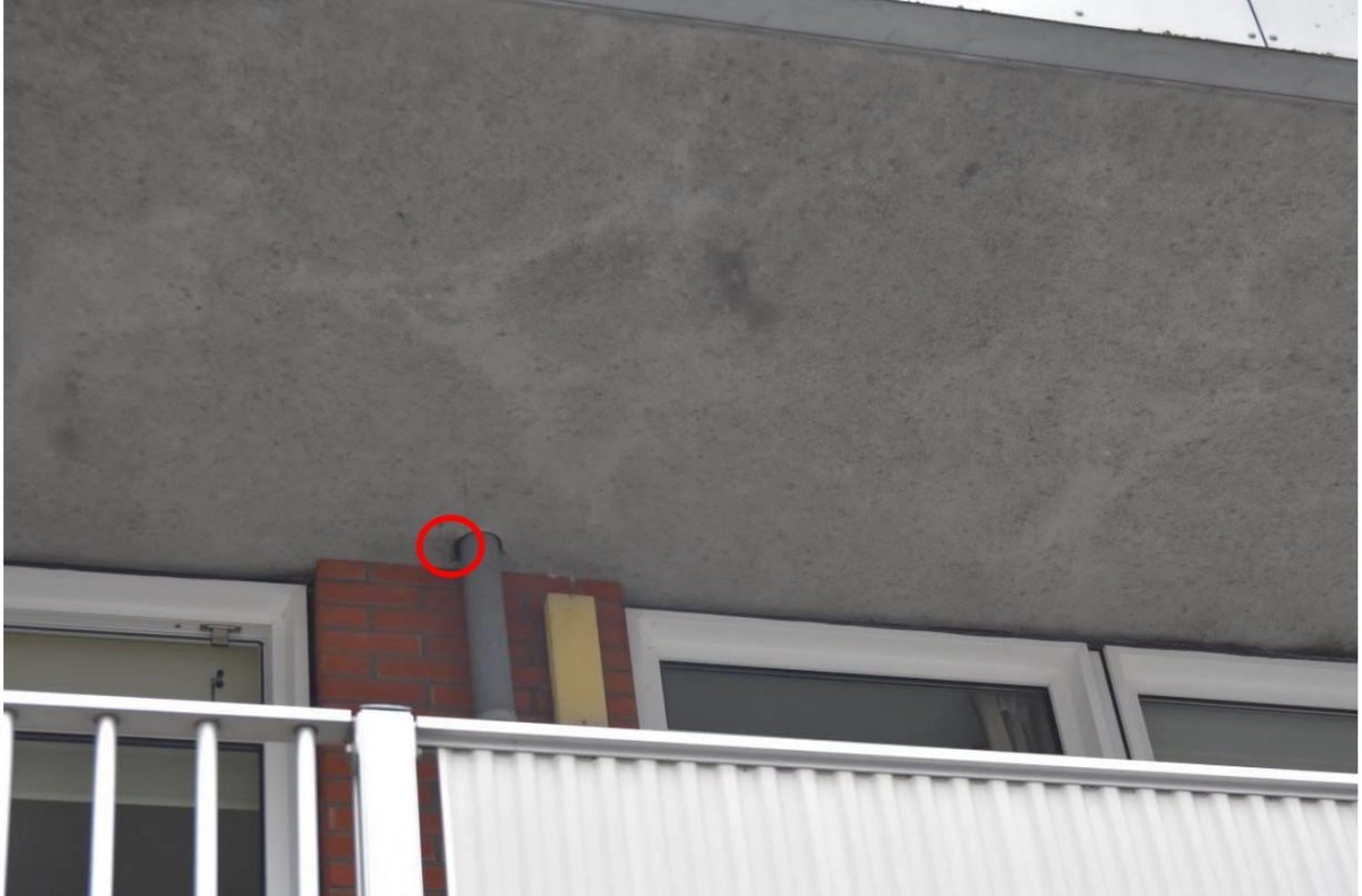
Figuur 4.7 De ruimte bij de afvoerpijpen van de woningen binnen het projectgebied geven vleermuizen toegang tot open ruimtes.
